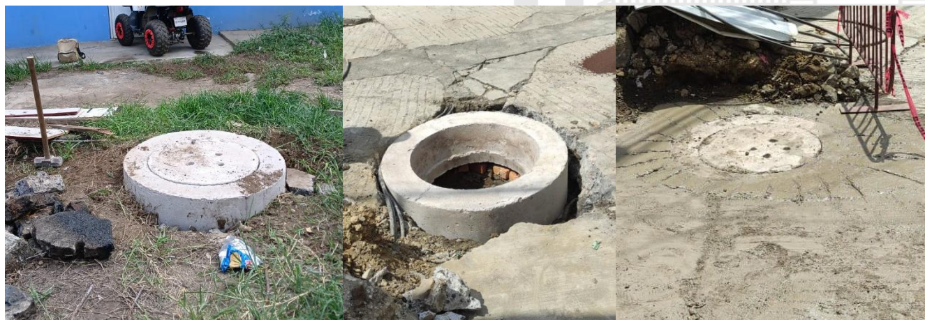
TAPAS DE REGISTROS PLUVIALES Y SANITARIOS
